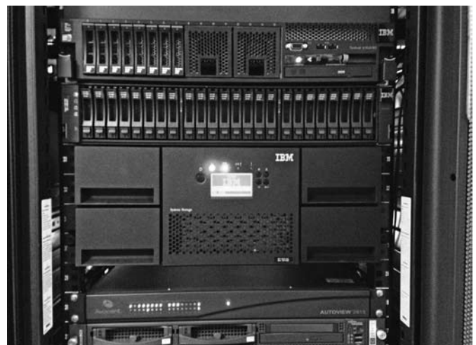
Einsatz modernster Technologie im Rechenzentrum
